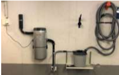
Dammsugaren i garaget
